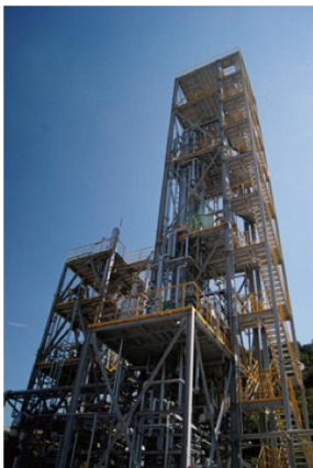
図 3. CO 2 回収パイロットプラント (兵庫県 相生)。20 t CO 2 /day の吸収能力を有する。高さ 40 m, 階段しかないので点検のために登ると息が切れるとのこと, 環境のみならず健康にもいいプラントのようだ。
